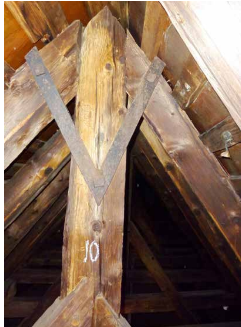
Bild der aktuellen Schäden am Dachstuhl: Klaffende Risse im Firstanschluss - Ziel der Notsicherung ist die Wiederherstellung der Standsicherheit der historischen Dachstuhlkonstruktion.
